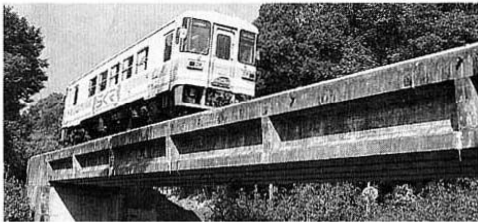
「PC橋」の先駆けとなった第一大戸川橋梁(信楽高原鉄道提供)
